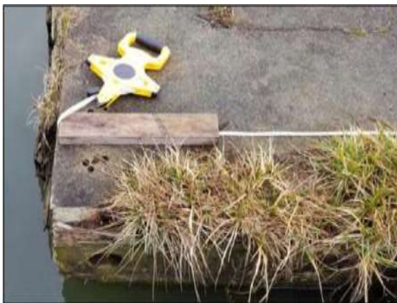
Image 9. Dommages sévères sur les bordures causés par des champignons.
