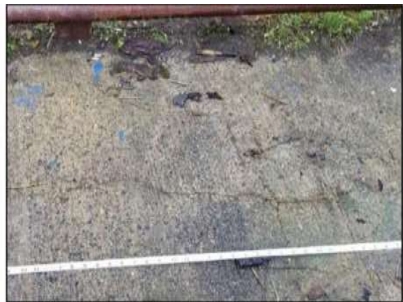
Image 10. Fissures types observées sur la surface du tablier de béton.
