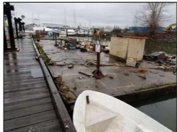
Image 2. Surface du quai en béton partiellement recouverte de débris anthropiques.
