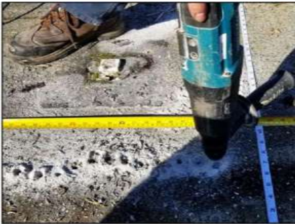
Image 3. Trous d'essai forés pour déterminer l'emplacement des cloisons sous le tablier de béton.
