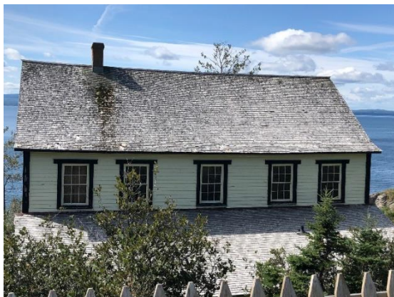
Photo 4 : Toiture Magasin Hyman après le passage de l'ouragan Dorian, 2019.
