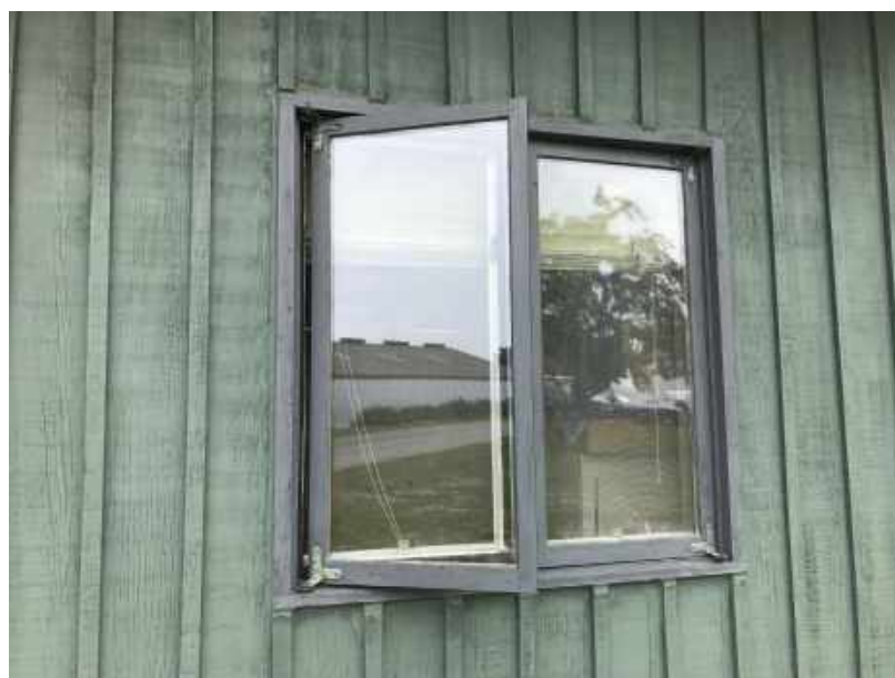
Figure 2 :- Vue de peinture à moulure d'extérieur et de couleur grise, à concentration de plomb; cette peinture se retrouve autour de fenêtres et de portes du bâtiment 143.
