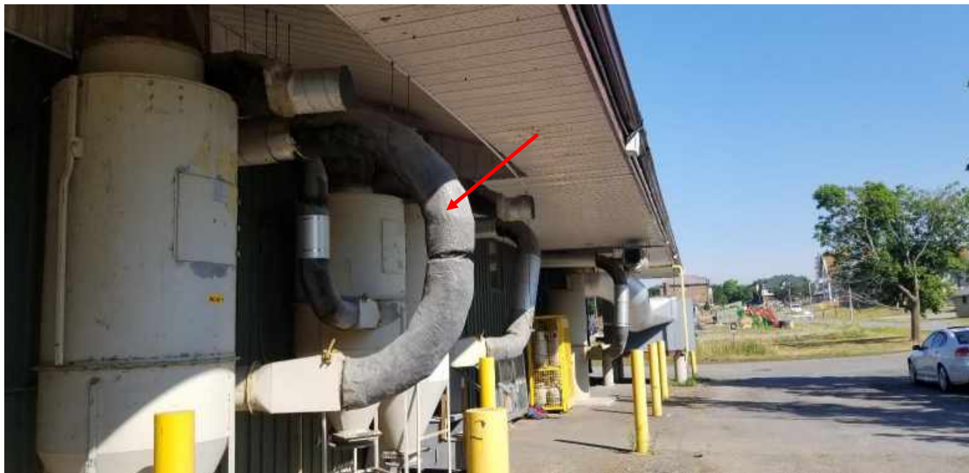
Figure1 :- Produits de goudron et (ou) de colle non friables, recueillis depuis le côté de l'est du bâtiment; ici, l'on confirma la présence de 8,39 p. 100 d'amiante chrysotile (AS-04 A-C).
