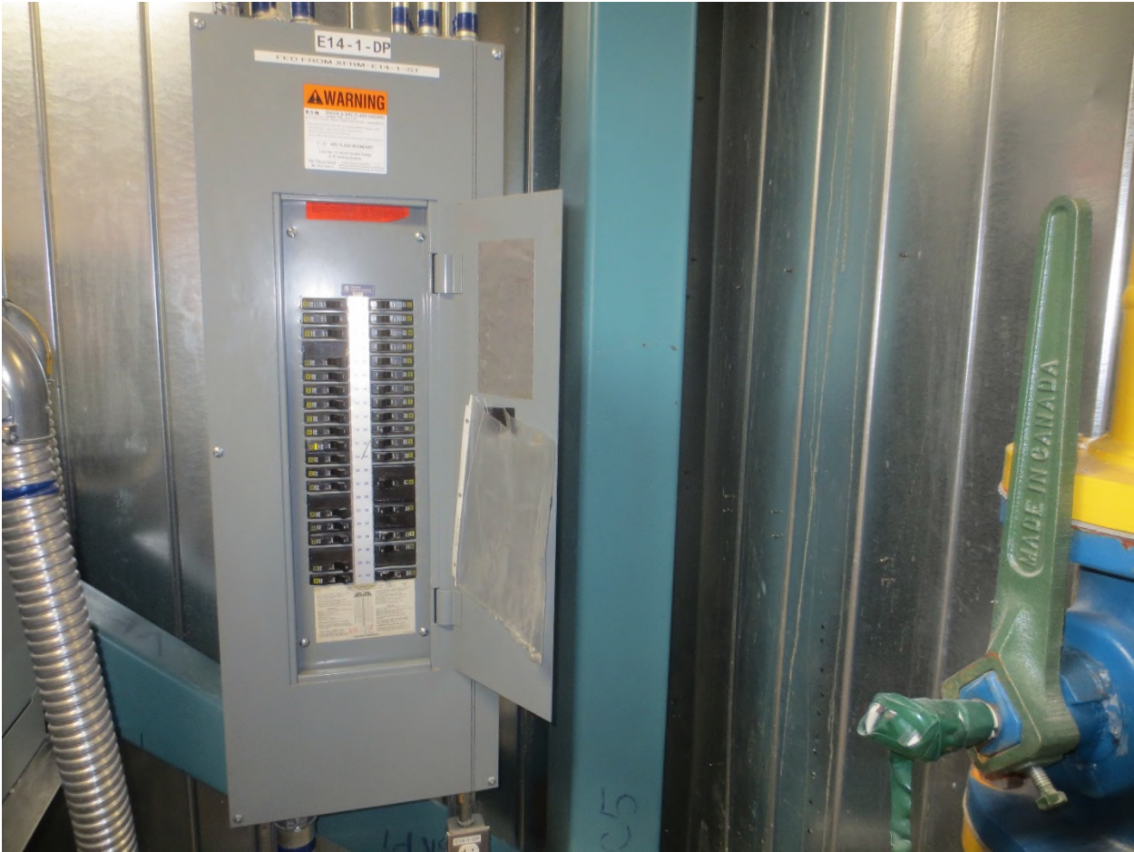
Panel E14-1-DP photo 1
