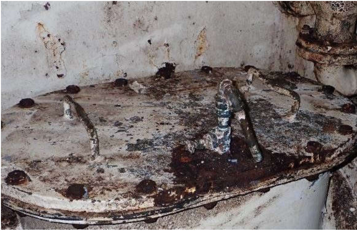
29. Début de corrosion sur le robinet de mise à l'air libre du tamis d'eau de mer
