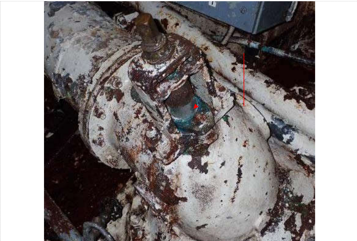
28. Vanne de coque principale à tribord à l'intérieur de la salle de propulsion en position ouverte – même chose à bâbord
