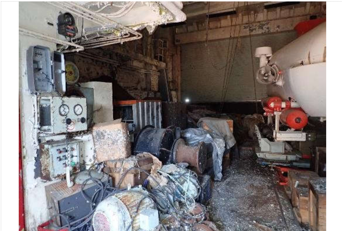
35. Pièces de rechange/magasins de pièces submersibles et générales à l'intérieur du hangar
