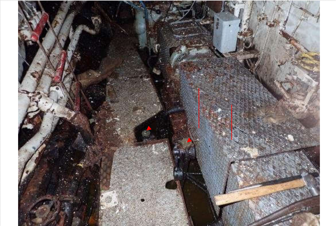
30. Tuyaux de sondage de réservoir de stockage d'huile pour CPP et engrenages – réservoirs pleins d'huile de lubrification propre
