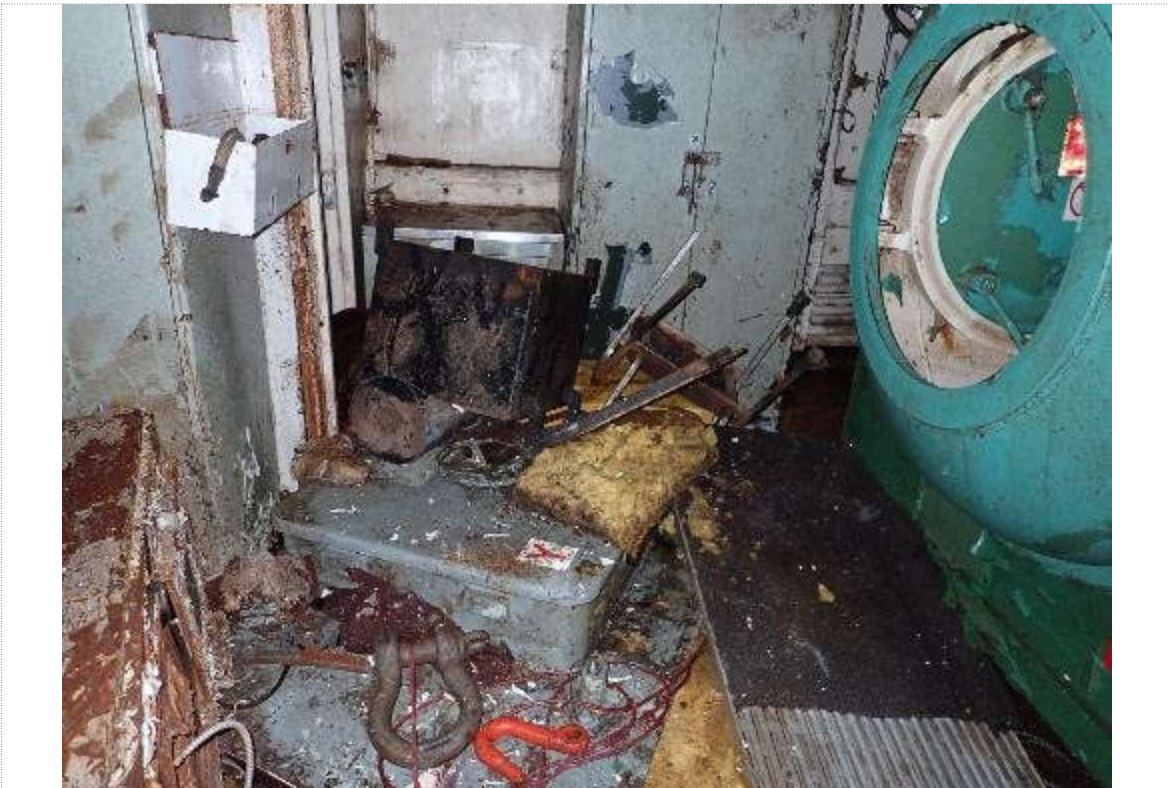
32. Compartiment de la chambre de décompression
