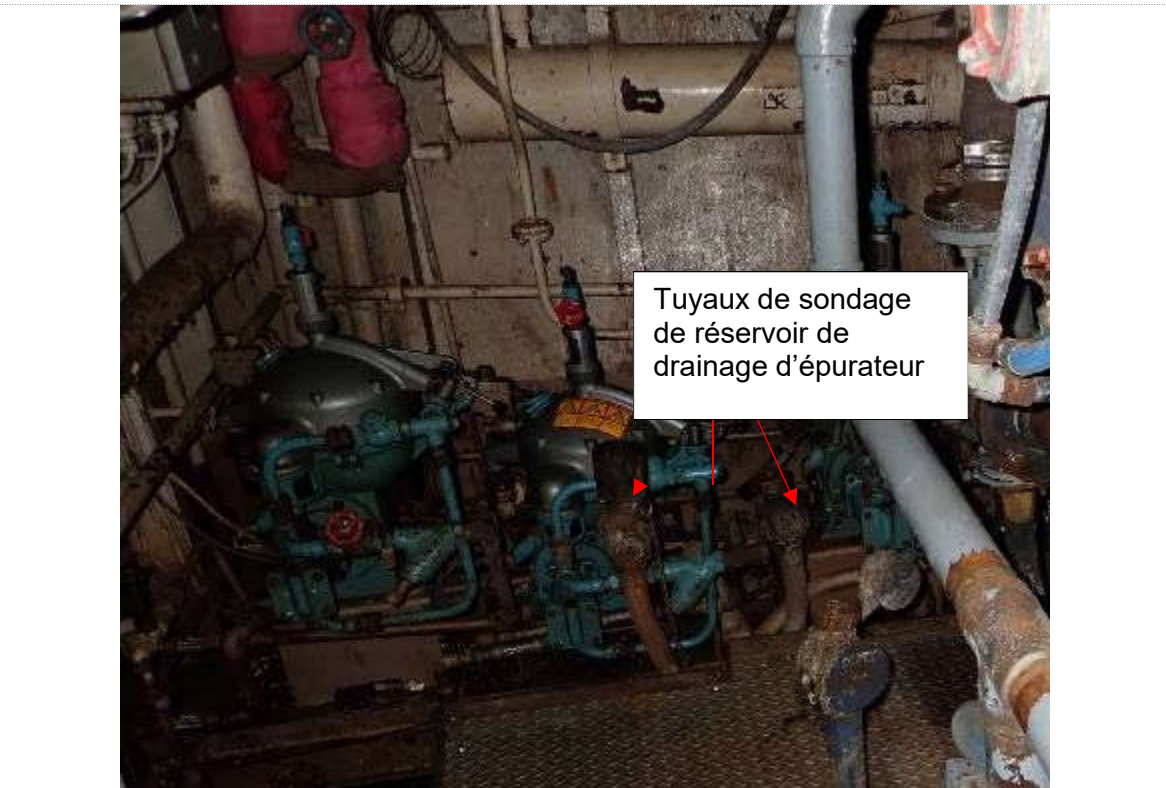
22. Épurateurs – noter les tuyaux de sondage pour les réservoirs de boues. Réservoir de boues de mazout, 70 cm, huile
