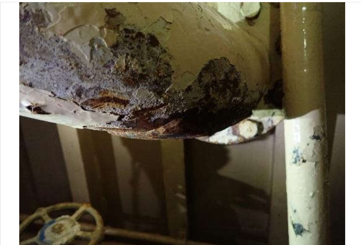
34. La conduite d'évacuation vers l'extérieur rapiécée commence à présenter des fuites.
