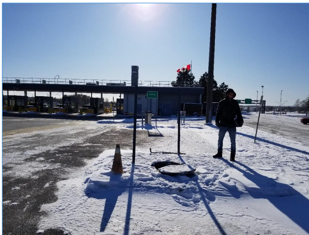
Photo 1 : Visée sud – Localisation du puits à colmater au poste de Saint-Bernard-de-Lacolle (Route 15).
