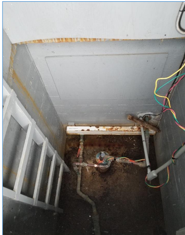
Photo 14 : Vue du puits de Stanhope situé à l'intérieur du cabanon.
