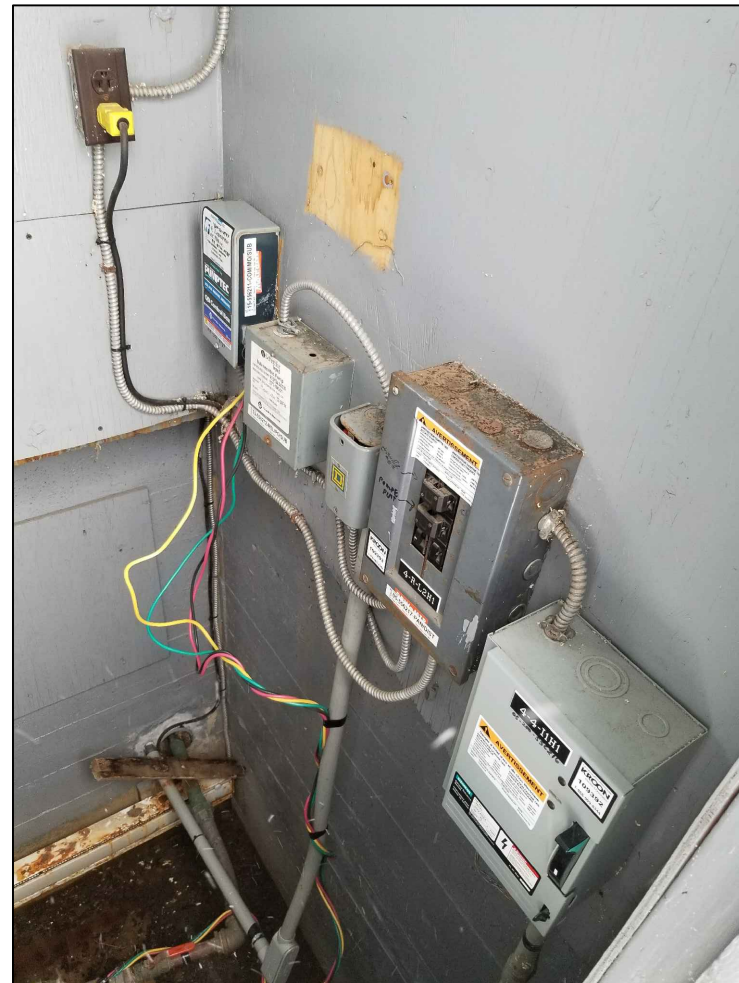
Panneaux et composantes électriques dans le cabanon
