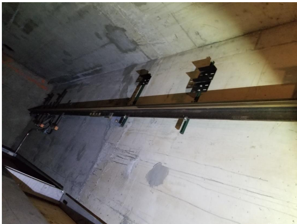
Photo 1 : Les plaques de crépi à base de ciment dans la cage de l'ascenseur ne contiennent pas d'amiante.
