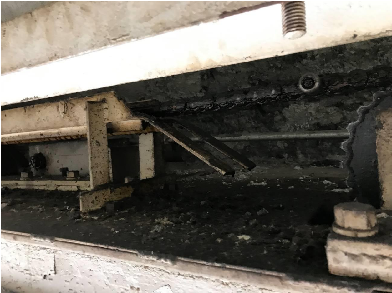
Photo 3 : Système de rails et de chaînes de la porte au-dessus de la porte du hangar et sous le dôme de béton (à l'ouest de la ligne d'axe 4, selon le Dessin A1-01127-20). Notez les débris de la protection contre le feu giclé. Les chaînes, rails mécaniques et les équipements mécaniques associés sont considérés comme étant contaminé avec l'amiante et devrons être décontaminé en suivant les protocoles de décontamination de l'amiante.
