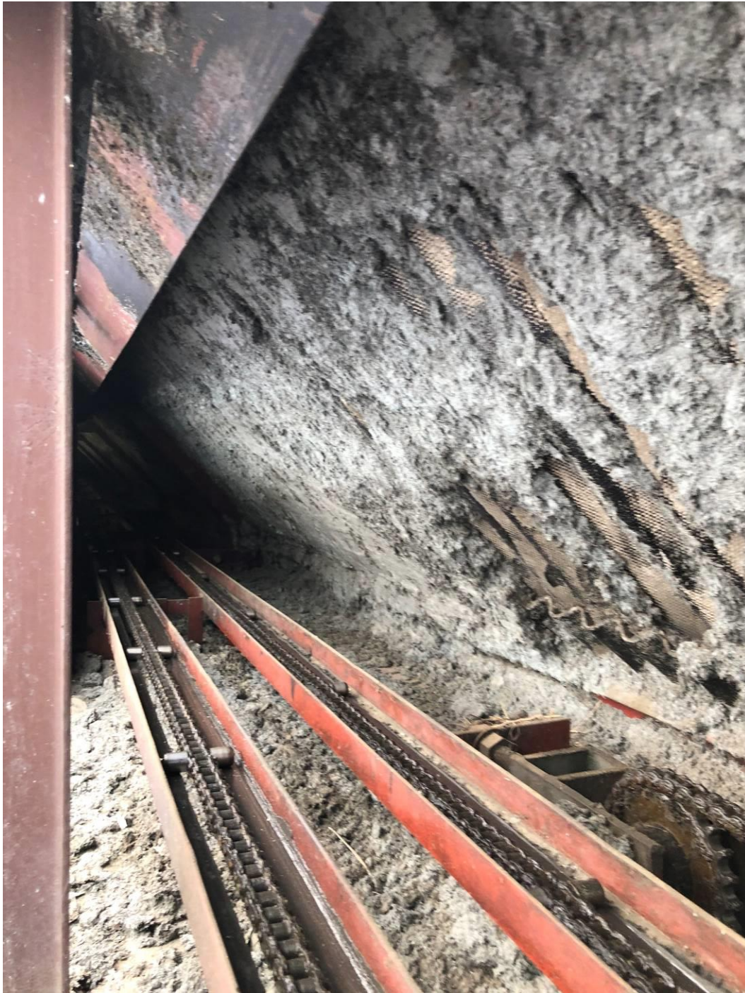
Photo 1 : Rails et chaînes de la porte vus de l'ouverture créer au niveau du toit (Dessin de référence A1-011227-20, Page 5). Photo prise au niveau du toit ouest, entre le dôme de béton et la poche de béton, en regardant vers l'est. Notez la protection contre le feu giclé sur les panneaux de revêtement de transite en angle (à droite de l'image) et des débris de protection contre le feu giclé dans le système de chaînes et sur les rails de la porte.
