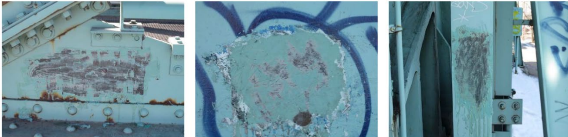
Échantillon après prélèvement (pont ave. St-Pierre/ave. Dollard direction nord) pris depuis les plaques de renfort et une poutre
