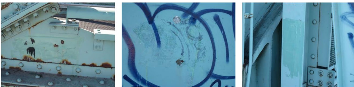
Échantillon avant prélèvement (pont ave. St-Pierre/ave. Dollard direction nord) pris depuis les plaques de renfort et une colonne
