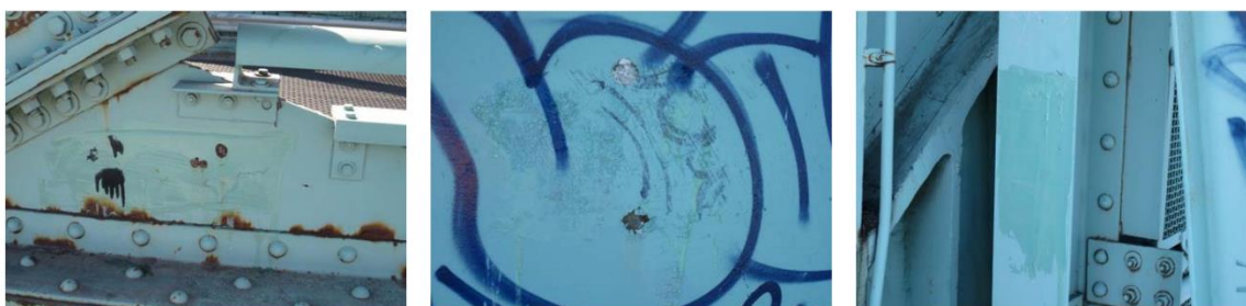
Échantillon avant prélèvement (pont ave. St-Pierre/ave. Dollard direction nord) pris depuis les plaques de renfort et une colonne
