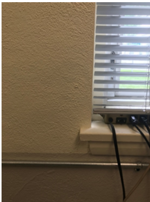
Photo 2: Il a été confirmé que le plâtre friable (lorsqu'il est perturbé de manière destructrice) gris texturé appliqué sur les murs et les colonnes du périmètre de l'ensemble du bâtiment contient 0,5 % d'amiante chrysotile (échantillon DST 02002246.000-05C-E).
