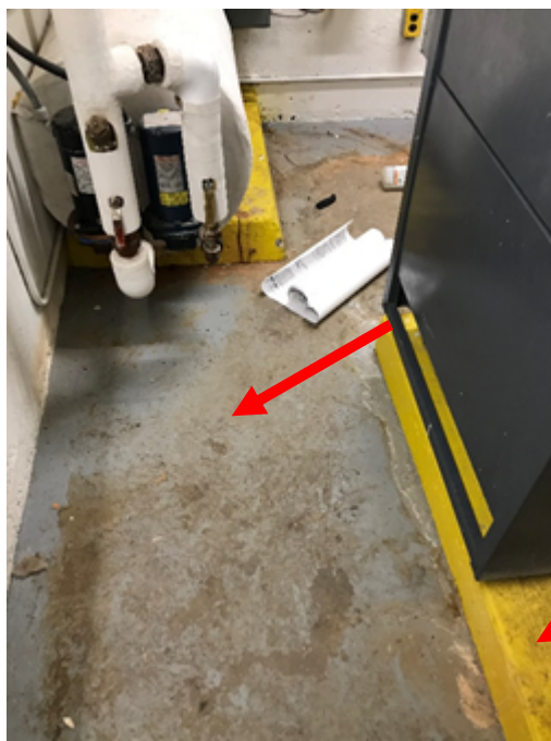
Photo 11: La peinture grise appliquée sur le plancher et la peinture jaune appliquée sur les blocs de béton sous la chaudière contiennent 348 et 1020 ppm de plomb (échantillon DST 02002246-LP01 & 02002246-LP02).
