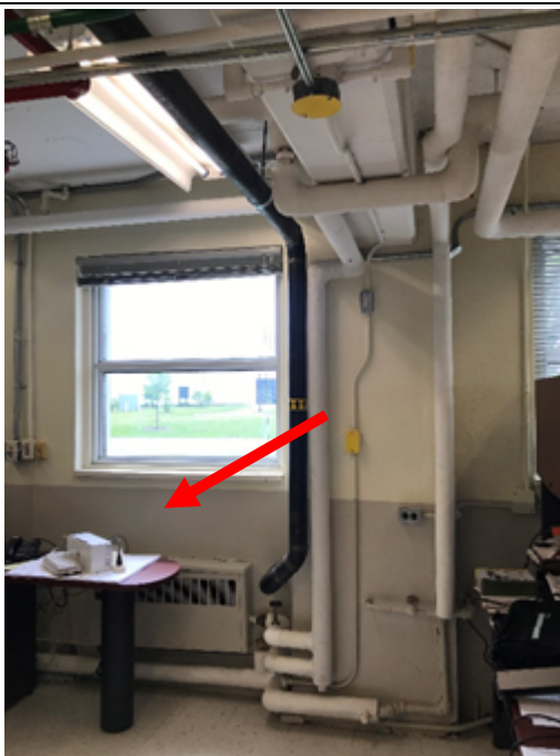
Photo 1: Il a été confirmé que le plâtre friable (lorsqu'il est perturbé de manière destructive) blanc lisse sur gris appliqué sur les murs de l'ensemble du bâtiment contient 0,5 à 1 % d'amiante chrysotile (échantillon DST 02002246.000-06A-E)
