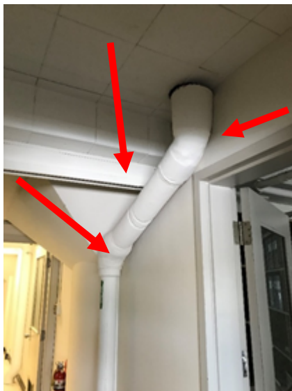
Photo 4: L'isolant friable "Aircell" sur tuyaux contient >75 % d'amiante chrysotile (échantillon historique Oakhill U62-03A) et l'isolant sur raccords de tuyaux contient 30-50 %, >75 % d'amiante chrysotile et 5-15 % d'amiante amosite (échantillon historique Oakhill ID U62-04A et 05A) ont été identifiés sur le tuyau de gouttières situé dans le couloir du deuxième étage à l'extérieur de la salle 212.
