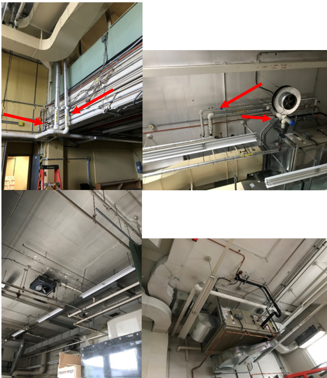
Photo 5-8: Des raccords de tuyaux isolés ont été observés dans tout le bâtiment sur les conduits de condensation à base pression et sur les conduits à vapeur à base pression. On suppose que l'isolation des tuyaux de type 'Aircell' est présente sous le revêtement métallique de chaque conduit.
