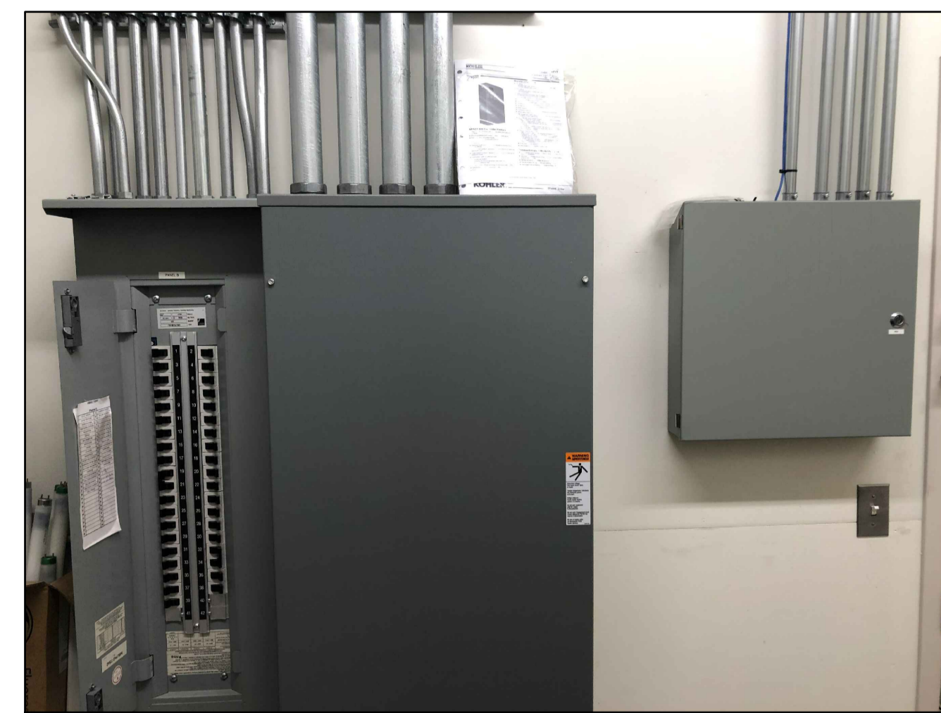
3 IMAGE 3 - ELECTRICAL ROOM WALL E-003 SCALE: N.T.S.
