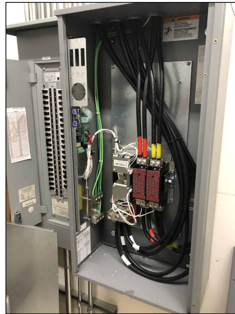
2 IMAGE 2 - EXISTING TRANSFER SWITCH E-003 SCALE: N.T.S.
