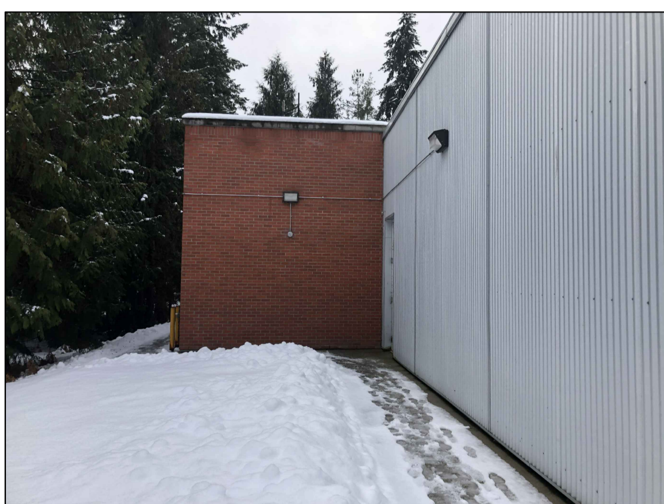
5 IMAGE 5 - EXTERIOR GENERATOR LOCATION E-003 SCALE: N.T.S.
