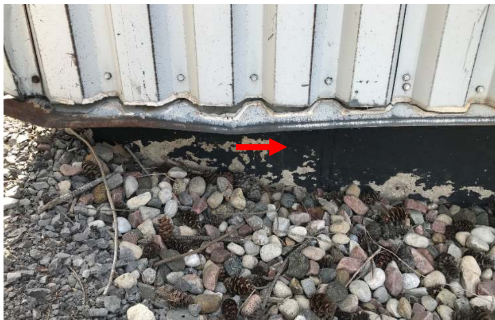
Photographie 2. Extérieur, fondation : il est confirmé que le goudron noir ne renferme pas d'amiante (ID de l'échantillon prélevé par DST : 2759-ACM1-3). Il est confirmé que le matériau renferme <5 ppm de BPC (ID de l'échantillon prélevé par DST : 2759-PCB1).
