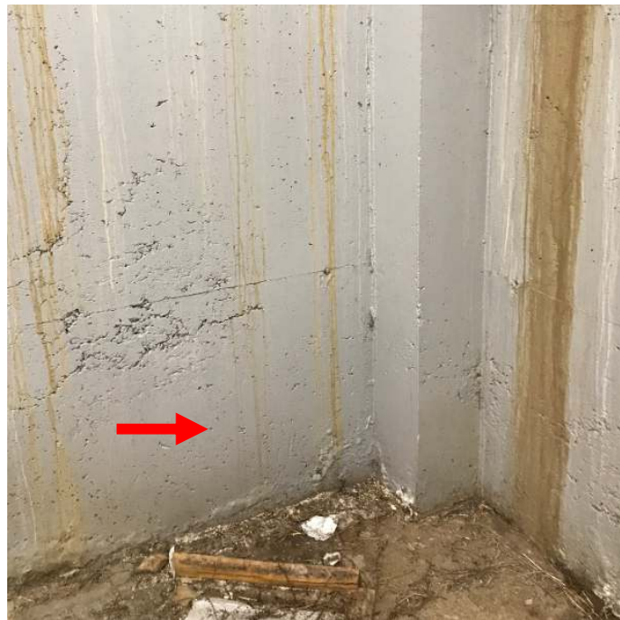
Photographie 1. Intérieur, mur du local des installations mécaniques : il est confirmé que la peinture grise renferme 20 ppm de plomb (ID de l'échantillon prélevé par DST : 2759-LP01).
