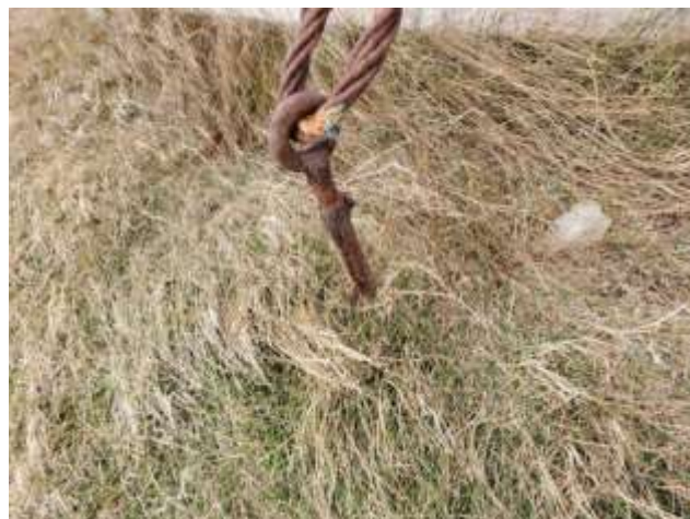
Hauban non ancré au sol
