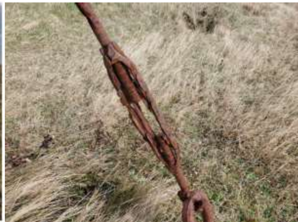
Tendeur de hauban sévèrement corrodé
