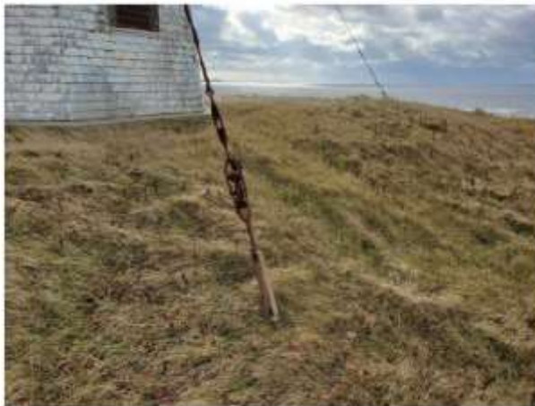
Câble de hauban corrodé
