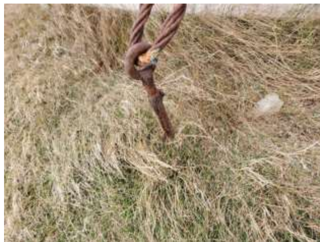
Hauban non ancré au sol
