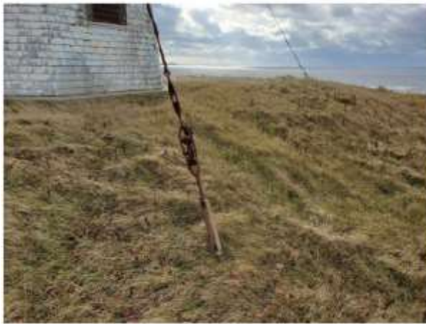
Câble de hauban corrodé
