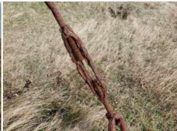
Tendeur de hauban sévèrement corrodé
