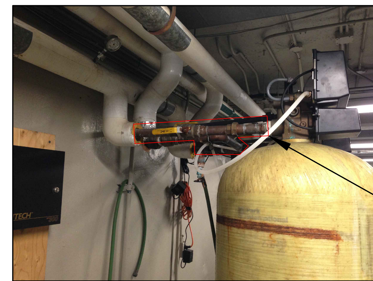
MODIFICATION DES TUYAUTERIES D'ENTRÉE ET DE SORTIE D'EAU DES ADOUCISSEURS ÉCHELLE: AUCUNE
