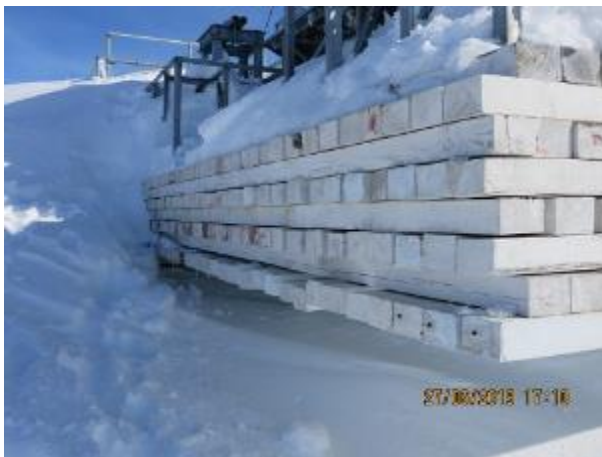
Figure 36 : Vue rapprochée du vide entre la structure en bois et le sol
