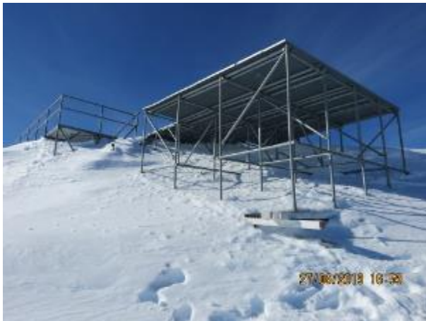
Figure 28 : Vue du manque de fondation de la partie sud-est de la zone de chargement
