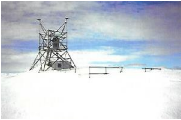
Figure 11 : Site du répéteur de faisceaux hertziens du mont Arthur sans les antennes (octobre 1994)
