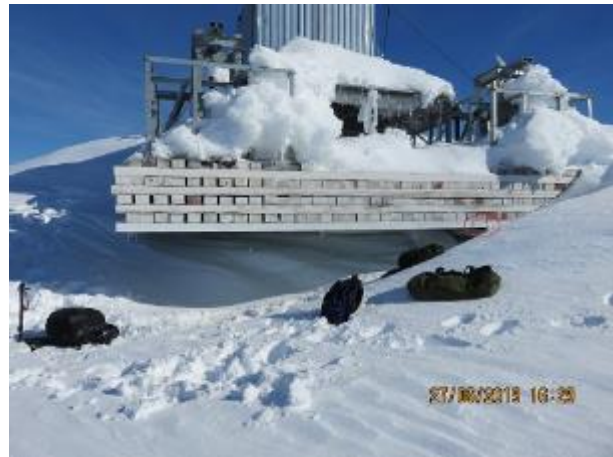
Figure 33 : Angle nord-ouest de la plateforme située directement sous l'abri de l'équipement. La structure en bois est maintenant en porte-à-faux (sur environ 20 pi ou 6 m) sur la section là où la glace a fondu. Le cercle rouge indique le point de rupture potentiel du bois.
