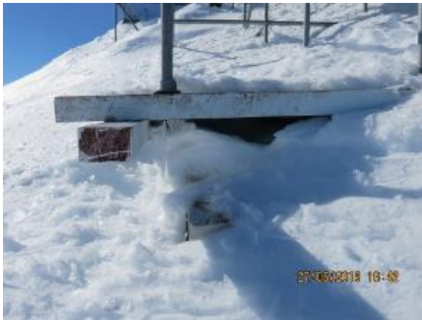
Figure 32 : Gros plan du manque de fondation. La couche supérieure des poutres en bois s'est séparée du reste de la charpente en bois. La glace a fondu sous la charpente en bois provoquant un tassement qui est à la source des forces qui ont séparé la charpente en bois.
