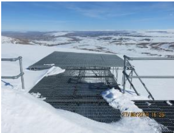
Figure 26 : Vue rapprochée de la zone de chargement. Une torsion et un tassement importants de la partie sud sont clairement visibles.
