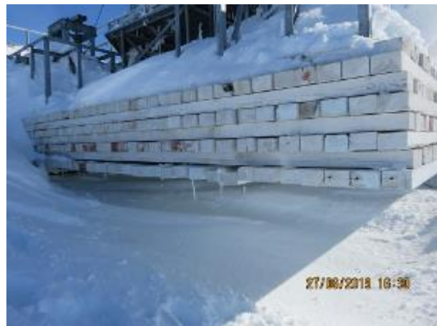
Figure 37 : Vue rapprochée du vide entre la structure en bois et le sol
