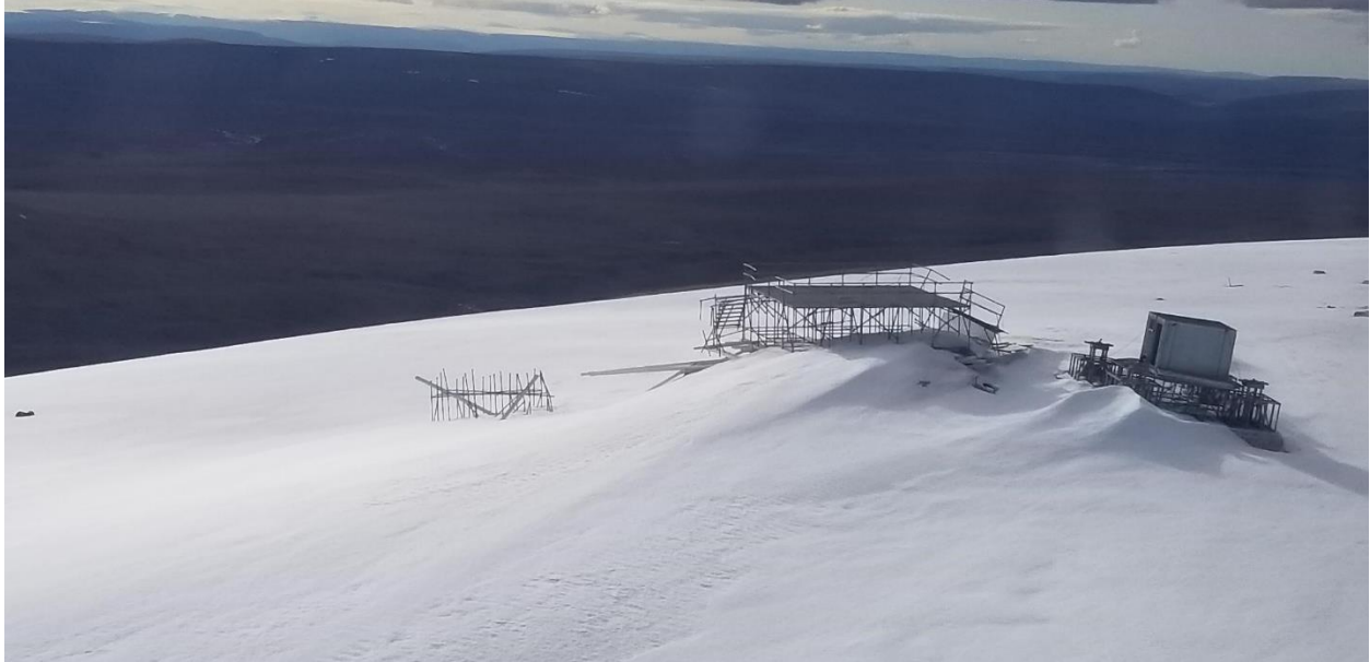
Figure 62A : 4 août 2021 – Bris de la plateforme du site du mont Arthur en trois sections distinctes
