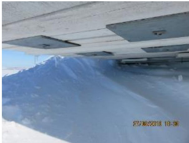
Figure 38 : Les poutres de l'angle nord-ouest de la plateforme sont fixées ensemble par des tiges d'acier filetées de 1 po de diamètre, des plaques en acier de 18 po x 18 po x 3/4 po et des rondelles d'acier de 2 ½ po x 2 ½ po x ½ po (toutes en acier galvanisé). Quatre (4) tiges sont situées à l'angle de la structure à 3 pi du centre. Les tiges de fixation ont permis d'éviter que les sections en porte-à-faux de la plateforme s'effondrent complètement.
