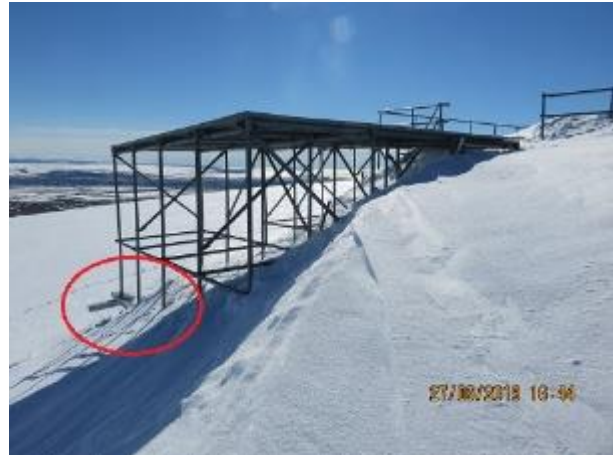
Figure 31 : Vue vers le sud de l'absence de fondation à la partie sud-est de la zone de chargement
