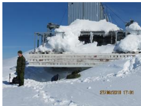
Figure 21 : Vue de la plateforme en direction est. Les poutres en bois (4 po x 6 po x 24 pi) ne sont plus soutenues par la couche de glace qui existait auparavant. La fonte de la glace a créé une cavité sous la plateforme.
