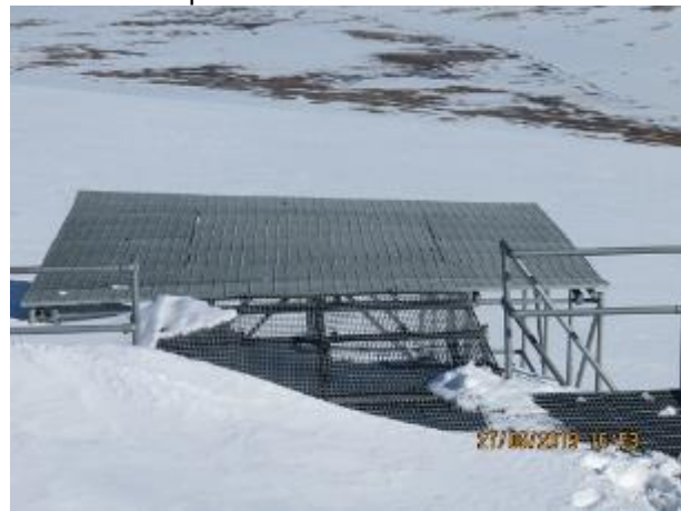
Figure 27 : Vue rapprochée de la zone de chargement déformée
