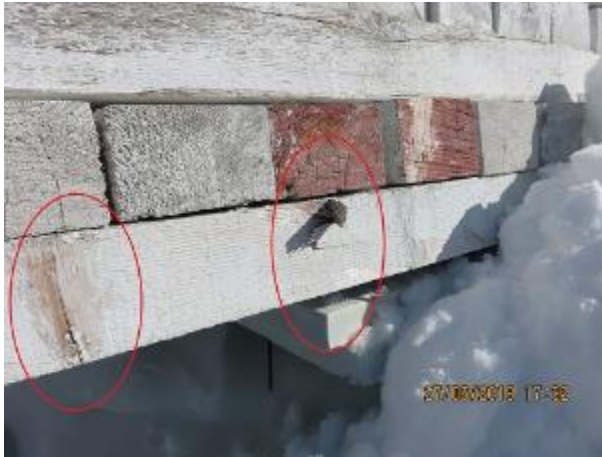
Figure 34 : Signes visibles de fissures dans la poutre (les lignes de ruptures sont visibles)
