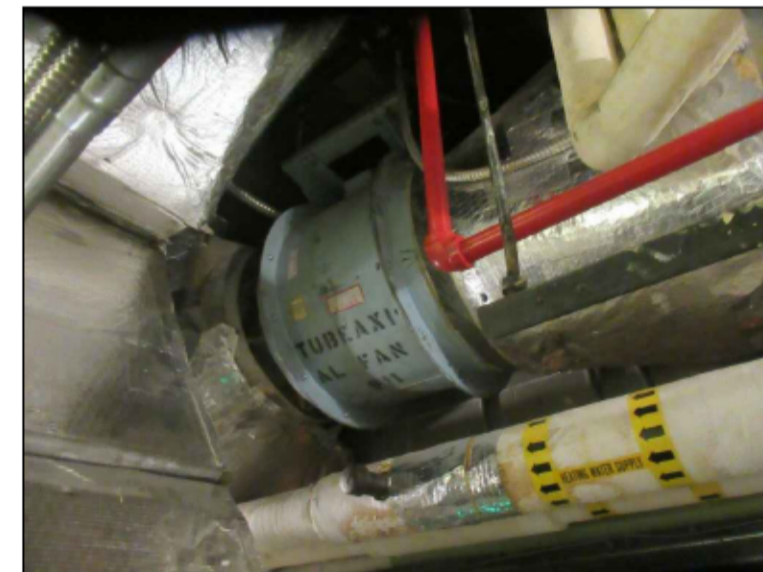
#18 - LU5 - BASEMENT EXHAUST FAN
