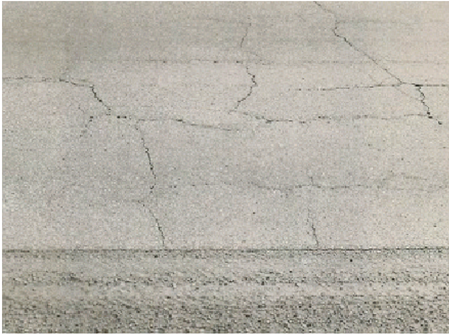
Figure 2.7.1(d) Light Map Cracks
