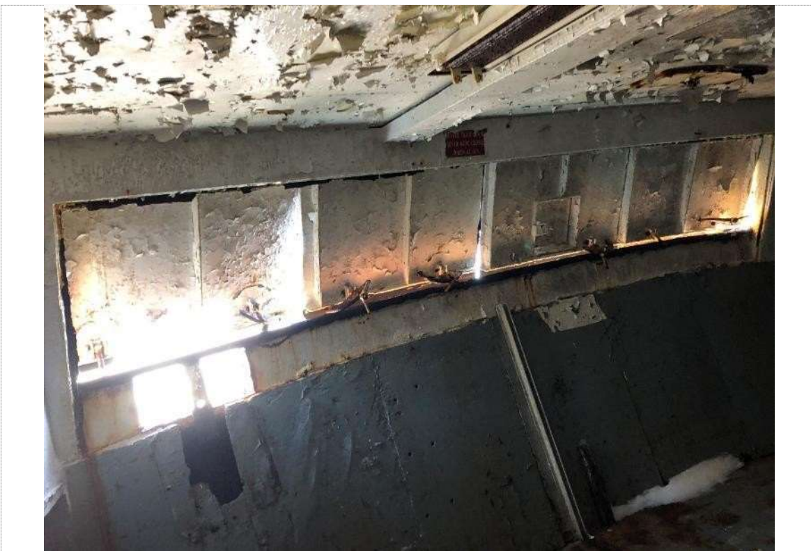
14. Zone de la voûte arrière – portes mal fermées
