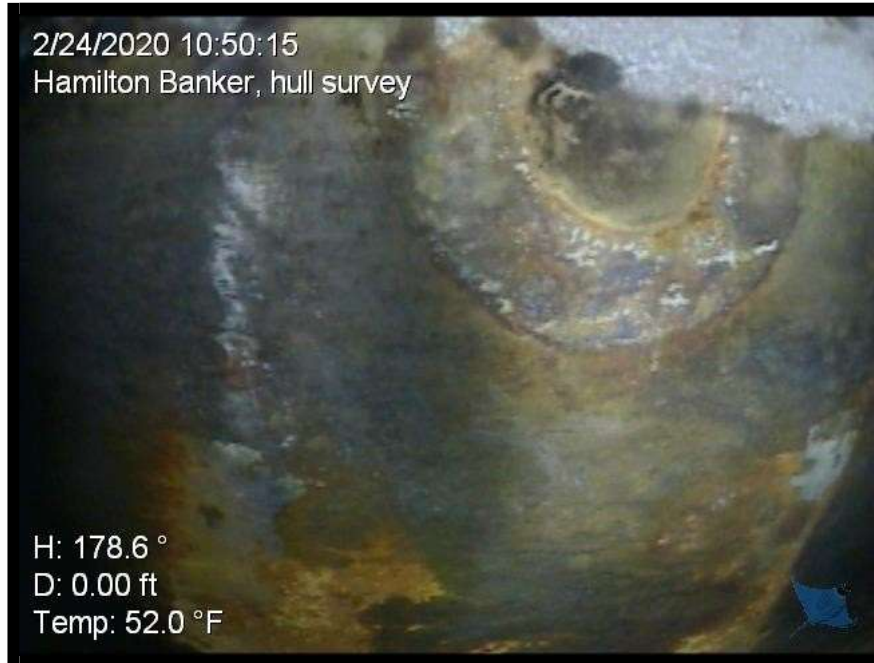
Figure 5 - Pénétration de la coque à tribord.
