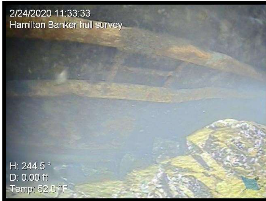
Figure 11 - Zone de quille de cale manquante à bâbord.
