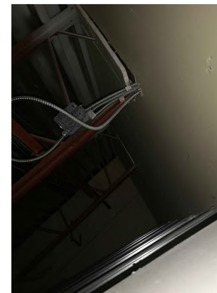
A09 PLAN - ENTRE-PLAFOND - SALLE ÉLECTRIQUE / COULOIR PLAN - BETWEEN CEILING - ELECTRICAL ROOM / CORRIDOR
