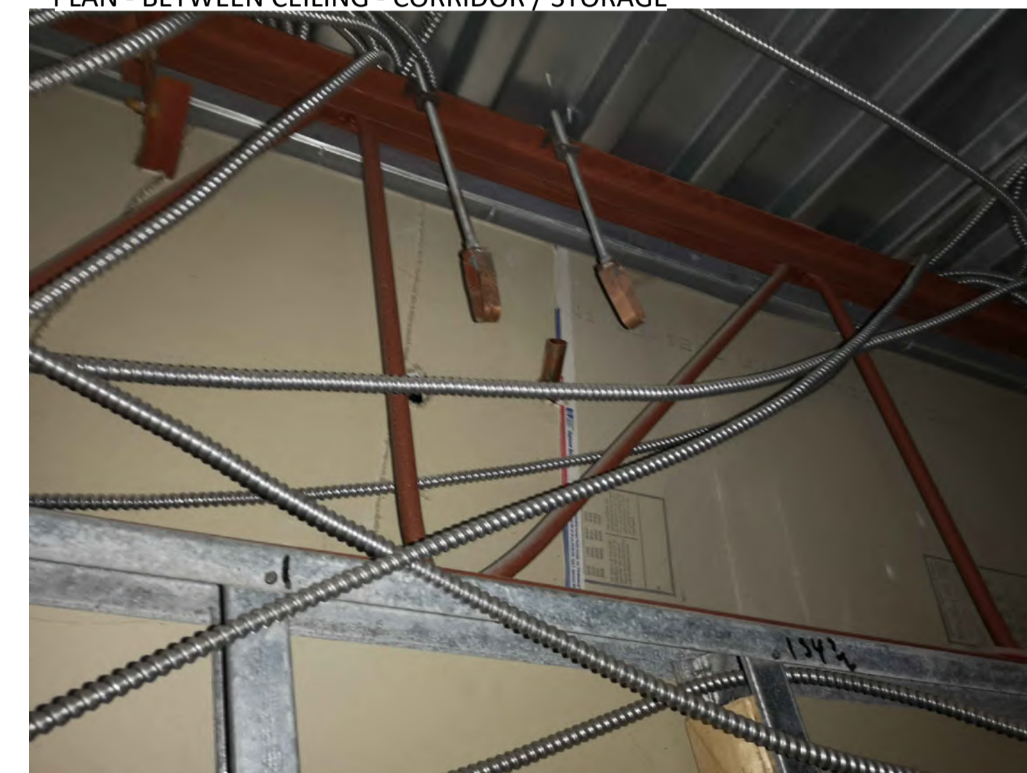
A06 PLAN - ENTRE-PLAFOND - COULOIR / SALLE ÉLECTRIQUE PLAN - BETWEEN CEILING - CORRIDOR / ELECTRICAL ROOM
