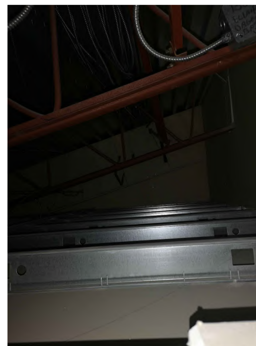
A08 PLAN - ENTRE-PLAFOND - SALLE ÉLECTRIQUE / COULOIR PLAN - BETWEEN CEILING - ELECTRICAL ROOM / CORRIDOR
