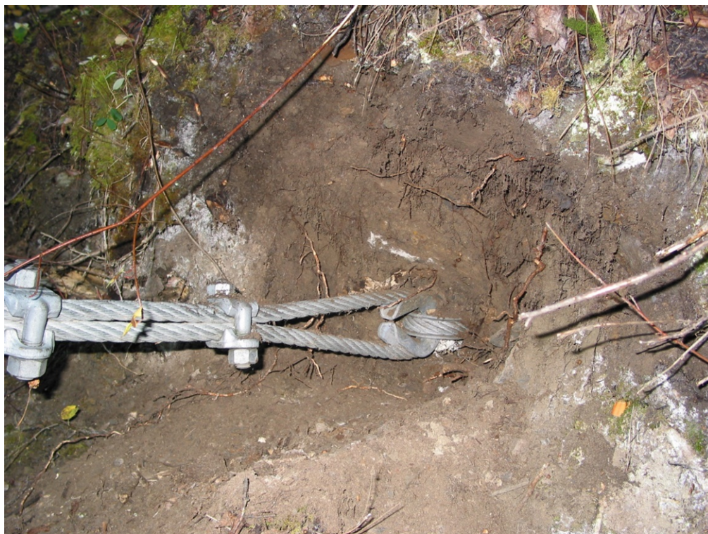
Photo 4. Ancrage inconnu du câble principal (rive droite, côté éloigné)
