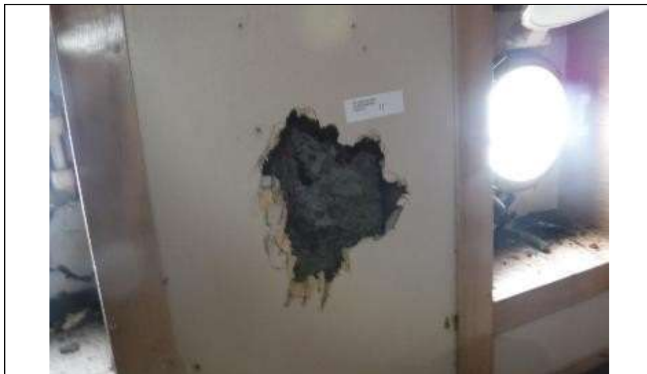
10. Isolant amiantifère derrière un revêtement, aux environs d'un poste d'équipage.
