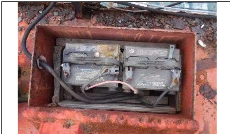
2. Batteries au plomb sur le pont de timonerie.
