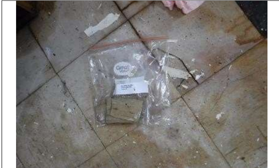
9. Carreaux de plancher amiantifères dans la timonerie et les emménagements.
