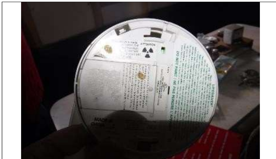
8. Détecteur d'incendie – Américium 241 radioactif.
