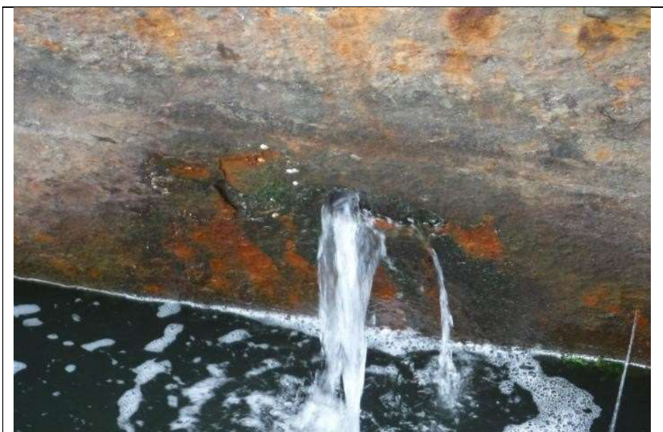
2. Section avant de la coque, à bâbord – Brèche
