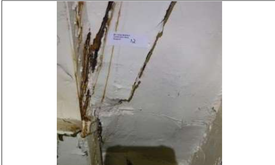
11. Isolant amiantifère dans la chambre froide.
