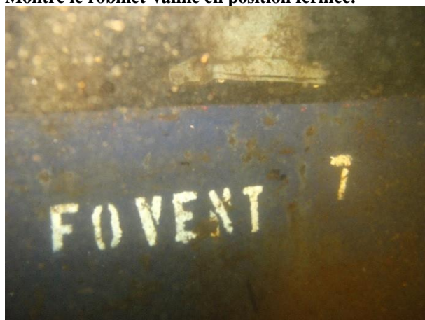
Montre l'évent de mazout bouché.
