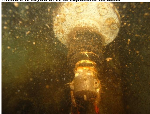
Montre la pénétration du tuyau recouvert d'un capuchon
