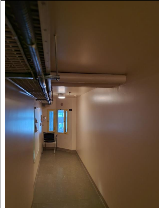
Conduits existant à l'endroit où il est possible de percé la cloison et avoir accès au plafond suspendu du département de la visite.
