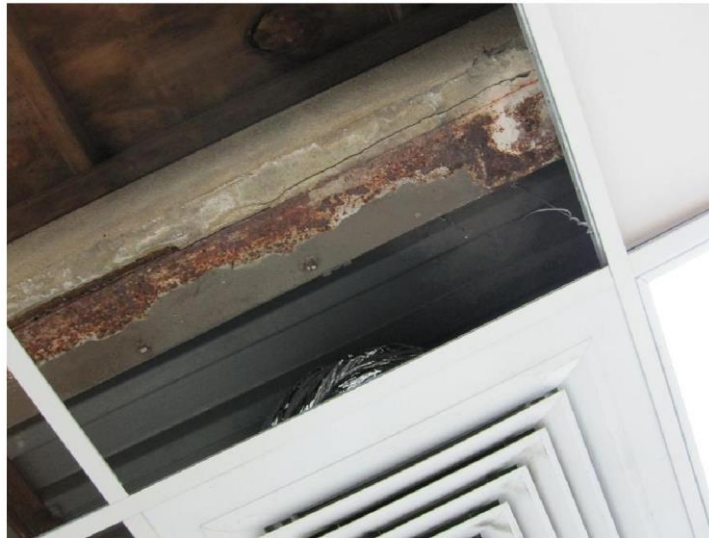
Photographie n° 3 : Corrosion des éléments au niveau du sous-sol
