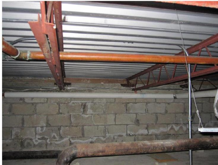
Photographie n° 1 : Efflorescence des murs de fondation du sous-sol
