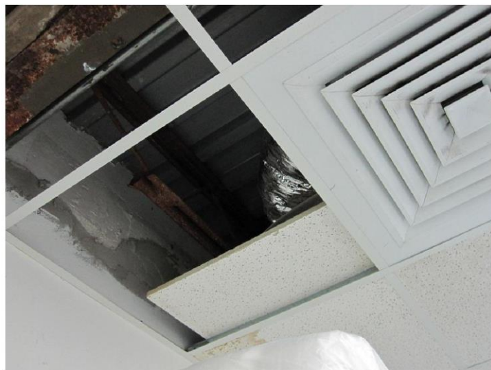
Photographie n° 4 : Corrosion des éléments au niveau du sous-sol
