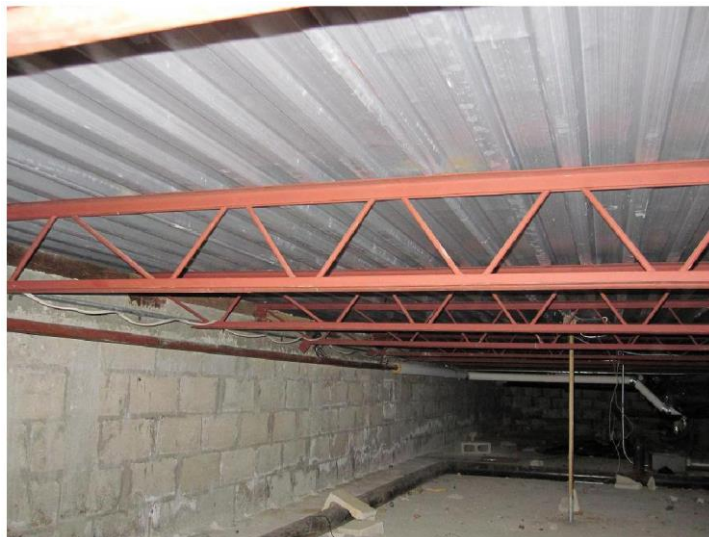
Photographie n° 2 : Efflorescence des murs de fondation du sous-sol
