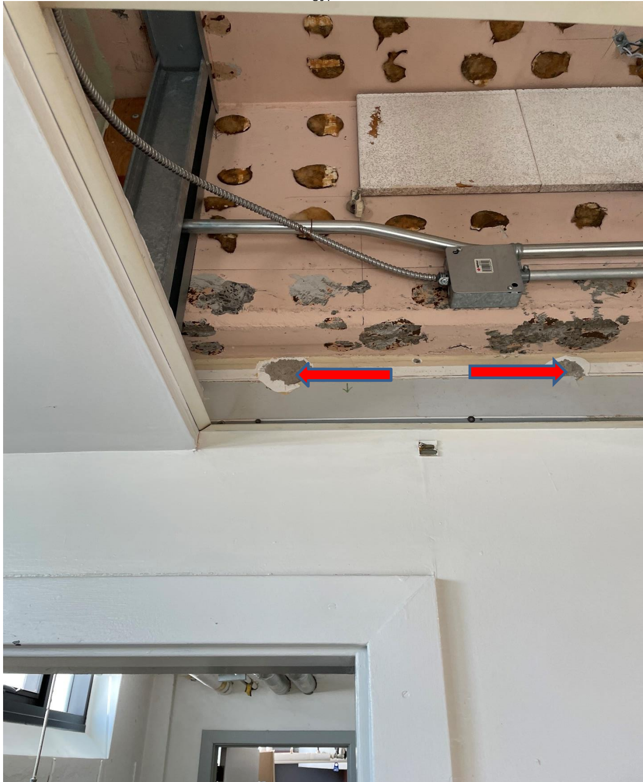
Photo 2 :- Le mur séparateur en plâtre amianté dans la salle 066 renferme 1 p. 100 d'amiante chrysotile. (Échantillon 08-A (épaisseur ou couche grise)). L'on confirma que les articles ci-
