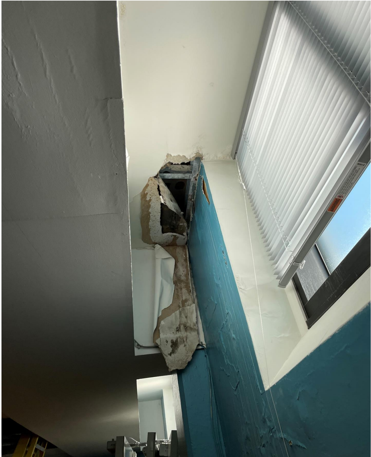
Photo 1 :- L'enduit de laitance amianté sur le mur périphérique en béton (mur fenêtré) renferme 1 p. 100 d'amiante chrysotile (Échantillon ID 02C). Ici, ce matériau est endommagé par de l'eau.
