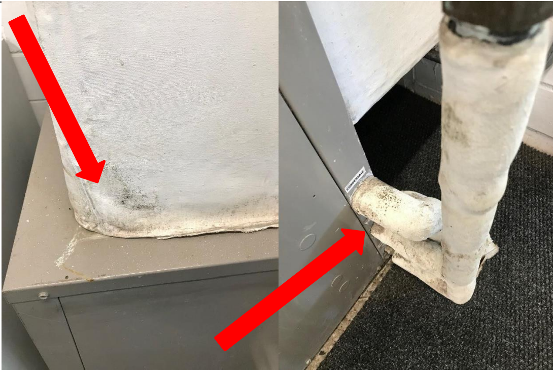
Photos 3 et 4 :- Observation de moisissure suspecte sur le conduit et à l'emplacement de tuyaux connexes (isolant non amianté) et ce, à l'extérieur du local 201.
