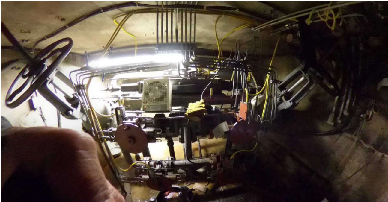
Photo 9. Salle des vannes d'intercommunication et des vannes d'isolement (permis equis pour le travail dans les espaces clos)
