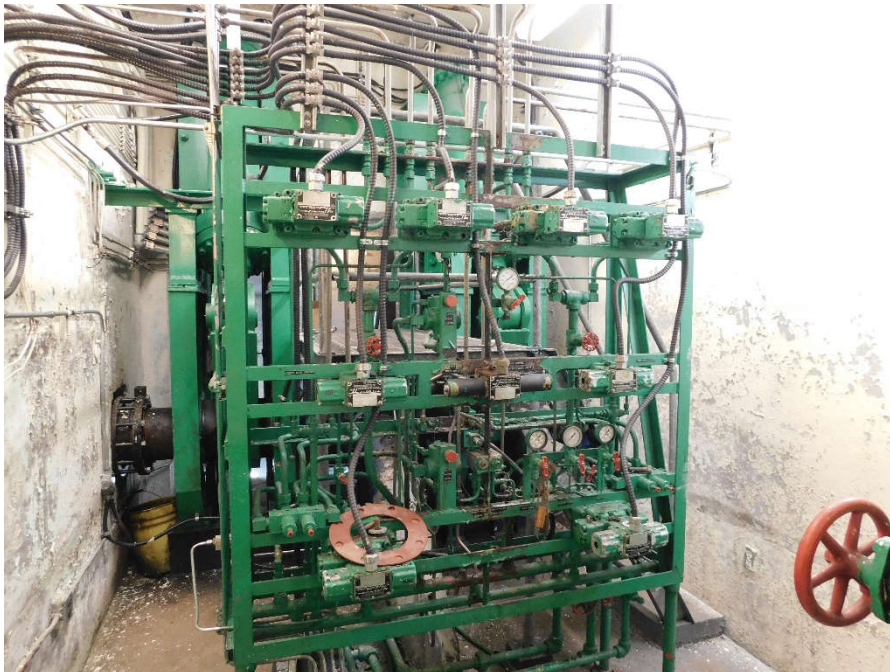
Photo 8. Ensemble de vannes hydrauliques, typique à plusieurs endroits du site
