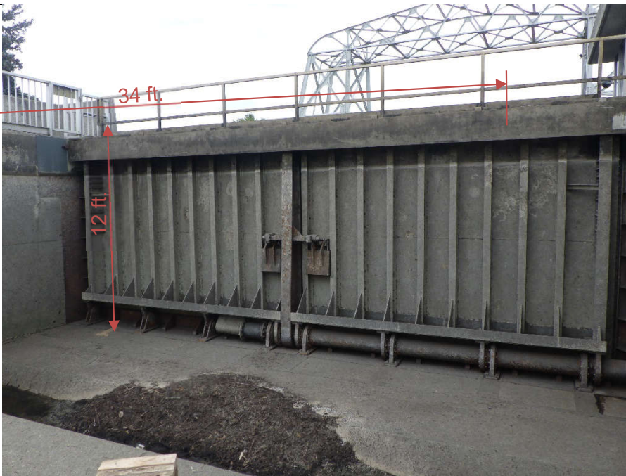
Photo 5. Porte supérieure sud
