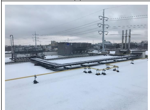
Photo 9 – Unité de condensation du toit (3)
