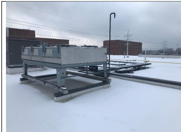
Photo 7 – Unité de condensation du toit (1)
