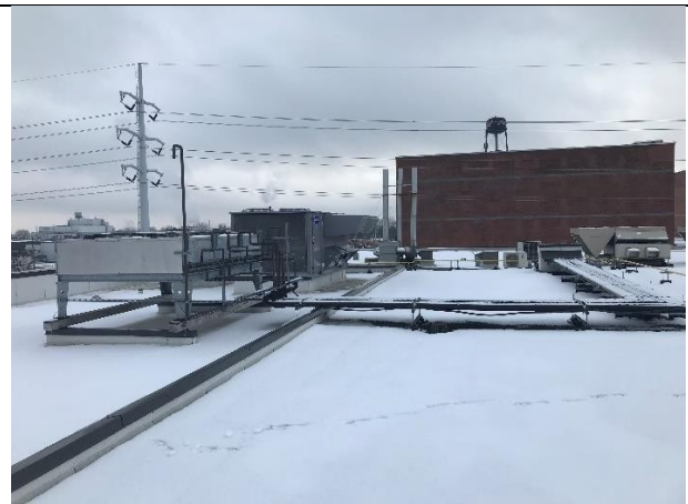
Photo 8 – Unité de condensation du toit (2)
