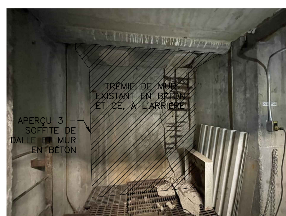
APERÇU N° 3 - MUR EN BÉTON, AU REZ-DE-CHAUSSEE / POUTRE DE DALLE, AU NIVEAU DU SOUS-SOL - APERÇU DE LA DÉLAMINATION ET DES FISSURES.
