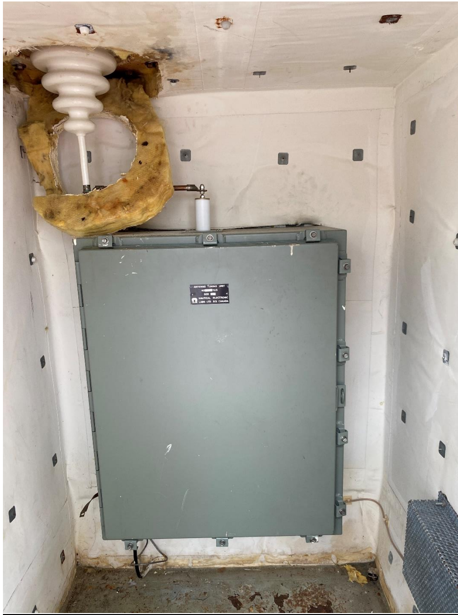
Figure 18.8-2 : USA du NDB à l'intérieur de l'enceinte
