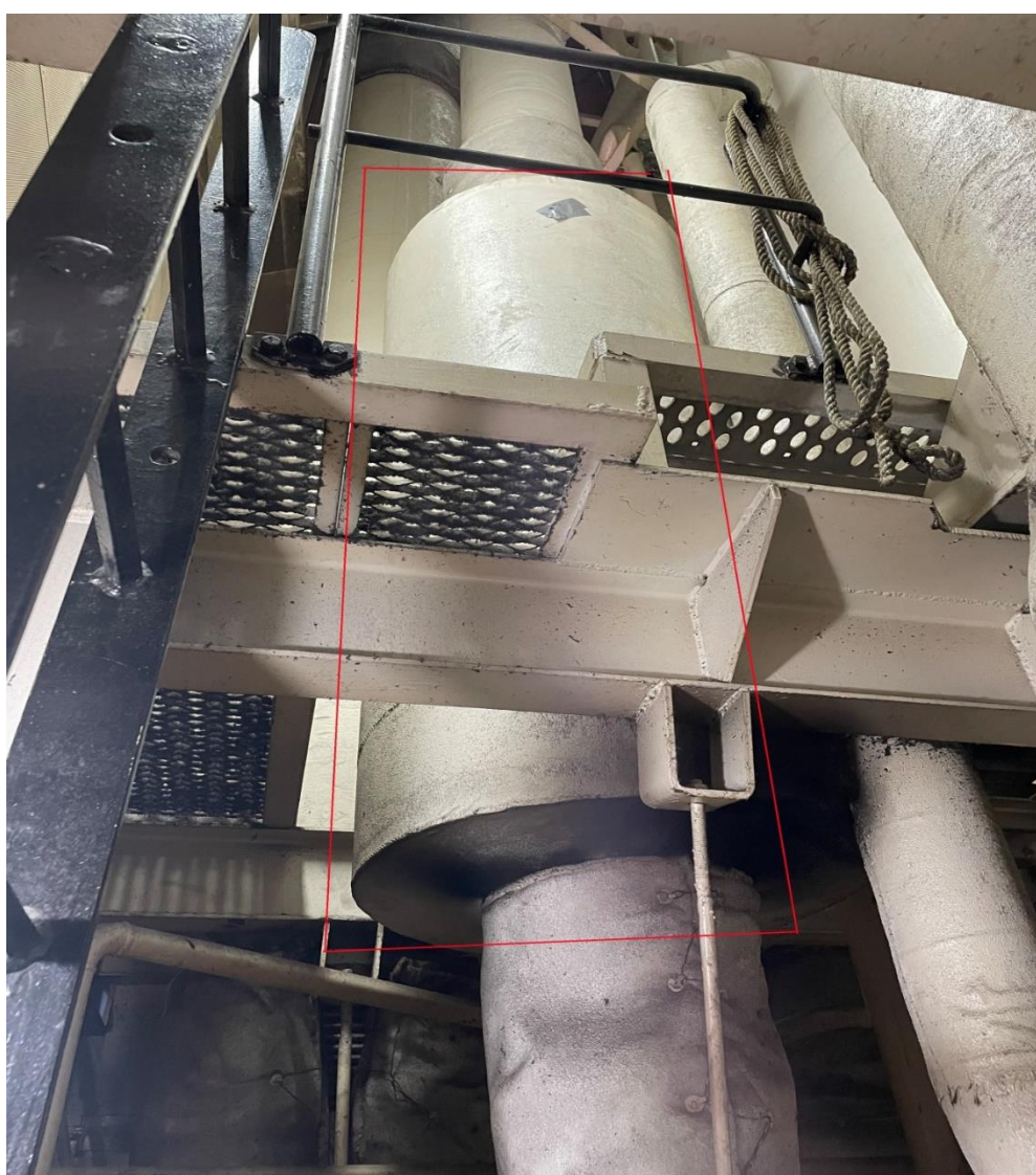
Figure 13.2.1 Silencieux de générateur auxiliaire
