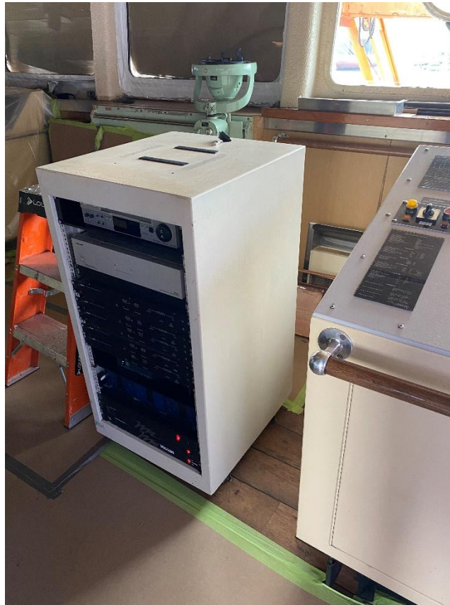
Figure 18.6-1 : Emplacement de l'armoire TVCF
