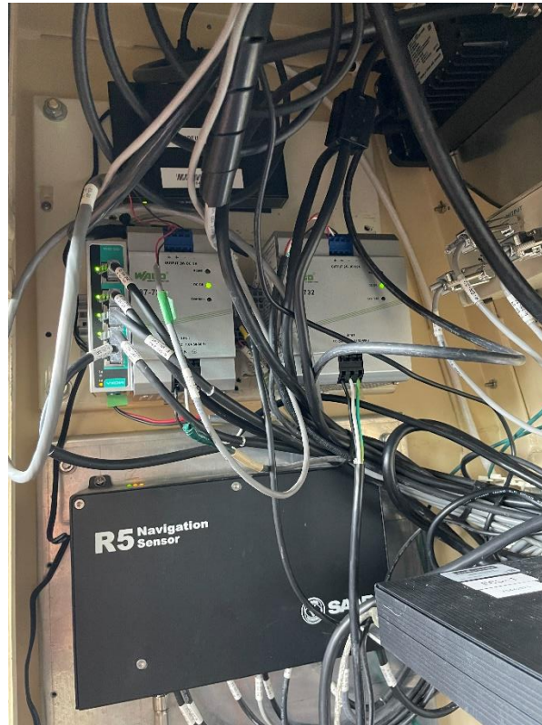
Figure 18.5-1: Bloc d'alimentation à remplacer.
