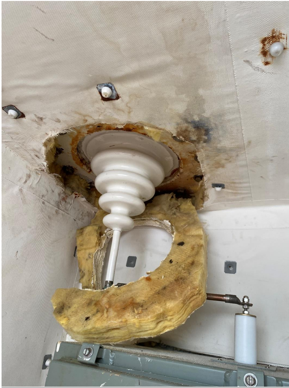
Figure 18.8-6 : Isolateur de l'USA en place
