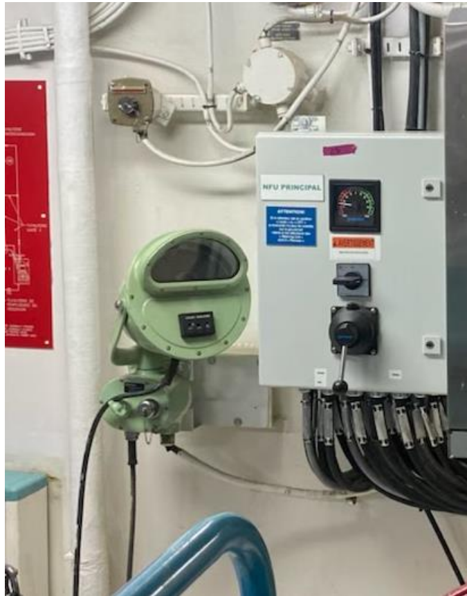
Figure 18.2-10 : Répétiteur existant dans la salle de l'appareil à gouverner
