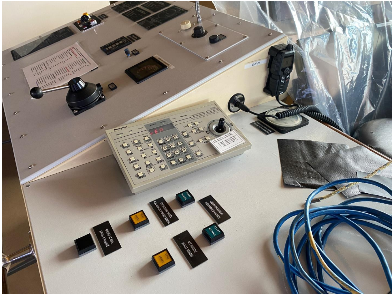
Figure 18.6-4 : Manette de commande TVCF dans le poste de l'aile tribord
