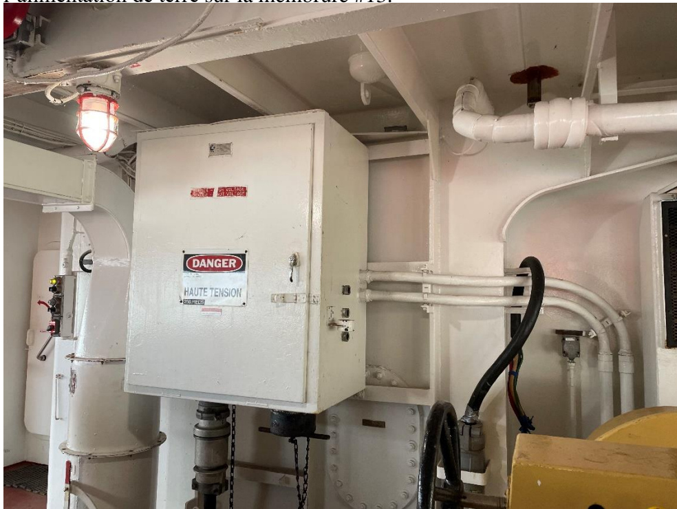
Figure 11.6.5 Panneau électrique de l'alimentation de terre
