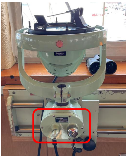
Figure 18.2-7 : Plaque de recouvrement à remplacer
