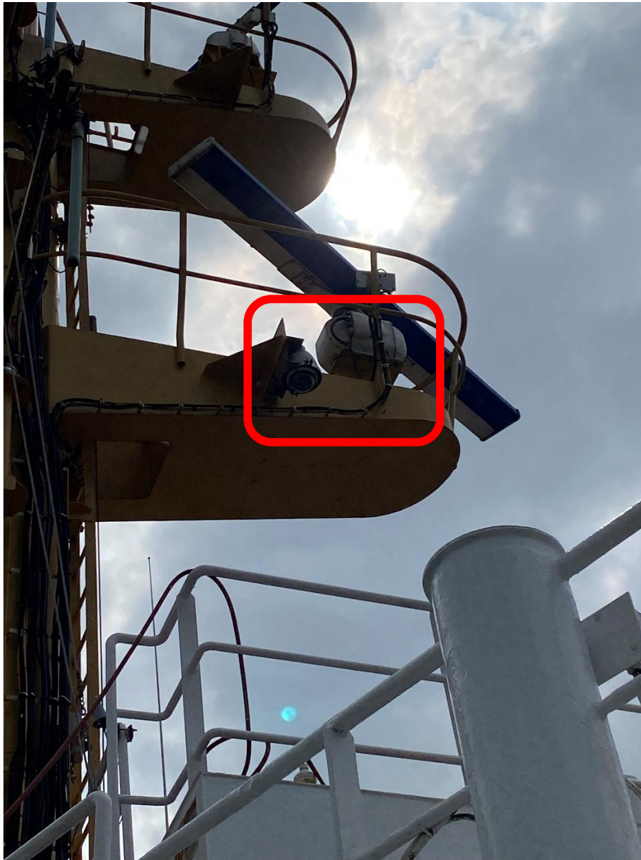
Figure 18.6-5 : Caméra de mât avant à remplacer
