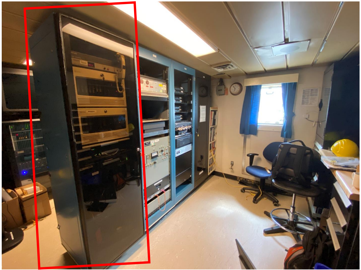
Figure 18.1-3 : Bâti du système téléphonique existant (bâti n° 3)
