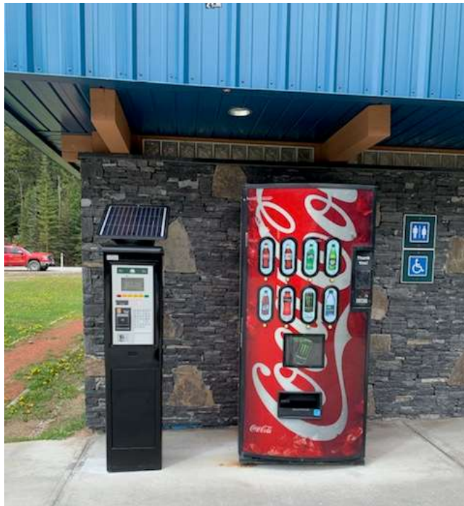
Figure 7. Image du lieu d'installation au Centre d'accueil du parc national Yoho. L'appareil automatisé figurant sur la photo sera enlevé. Courant alternatif accessible derrière la distributrice de boissons gazeuses.
