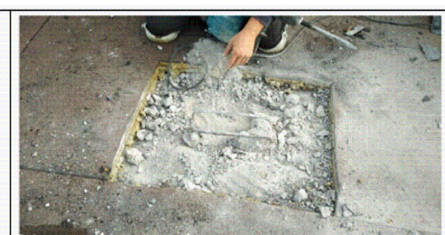
CONCRETE PARTIALLY REMOVED WITH REBAR REMAINING / BÉTON PARTIELLEMENT ENLEVER AVEC ACIER EN PLACE
