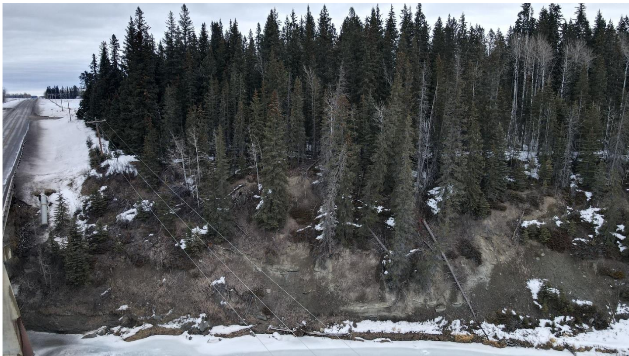
Figure 3: Vue aérienne de la rive droite du côté éloigné depuis la rive gauche du côté intérieur
