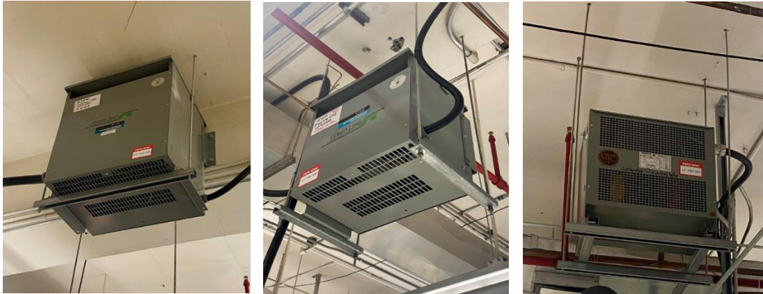
Figure 3-4 Exemples de transformateurs suspendus au plafond de l'atelier
