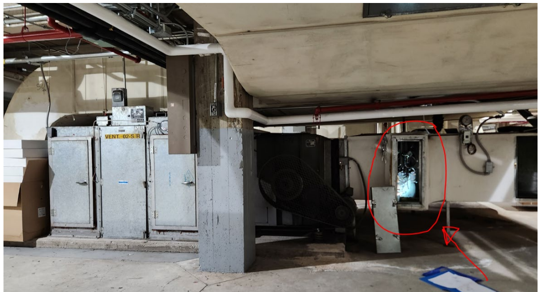
Photo 4 : Serpentin de refroidissement à remplacer dans l'unité existante.
