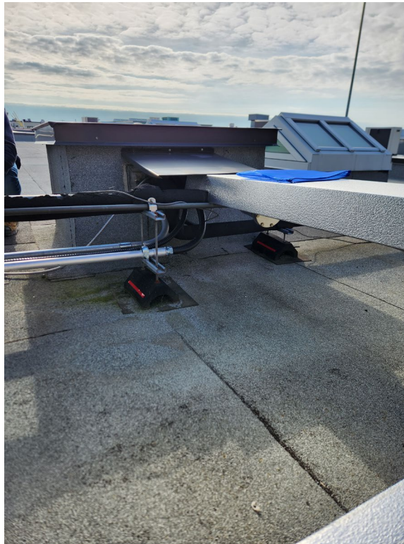
Photo 3 : Boîte en toiture pour le passage des tuyauteries de réfrigérant.
