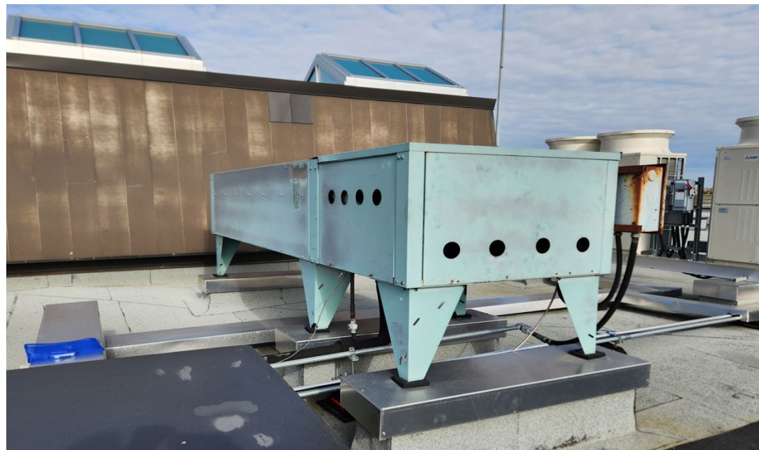
Photo 2 : Unité de refroidissement à remplacer
