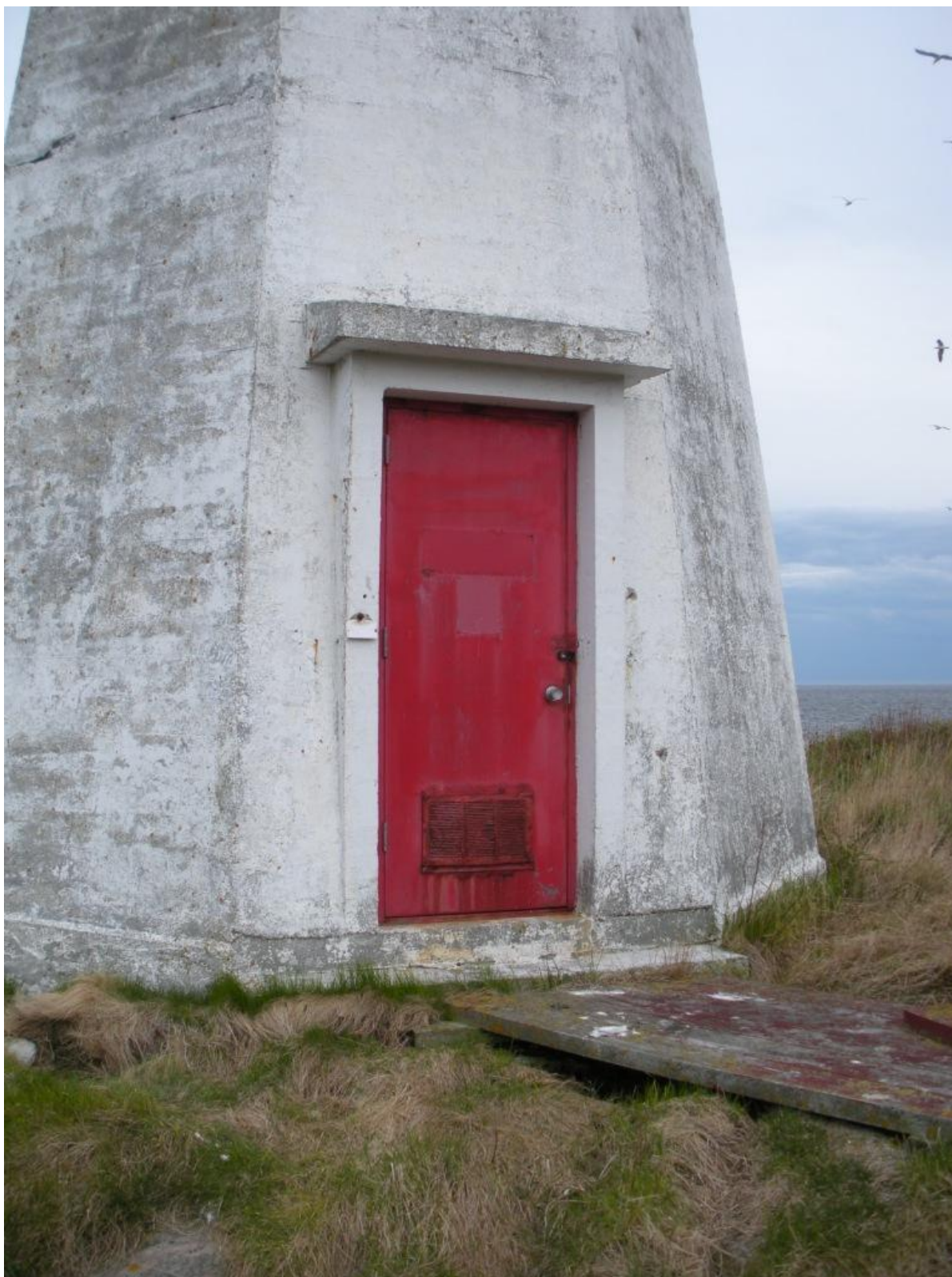
Photo 5 : Vue de la porte d'entrée à gratter et à repeindre
