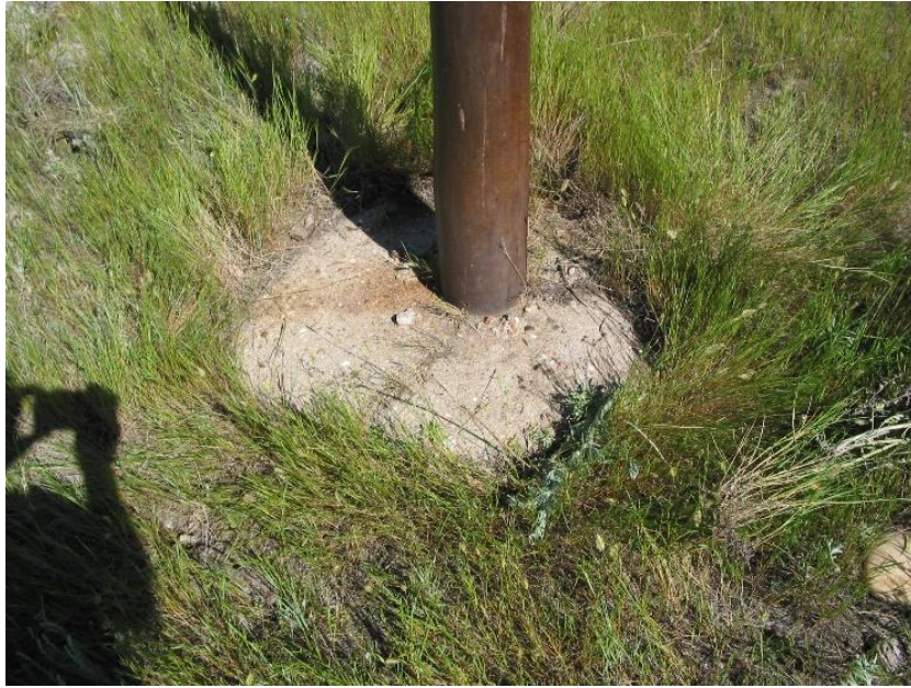
Figure 8. Montant fixé au socle de béton du côté arrivée sur la rive droite
